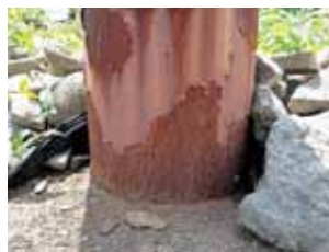
錆びついた支柱
