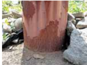
錆びついた支柱
