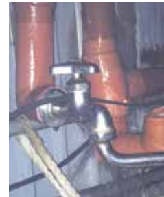
防寒していない部分からの漏水
