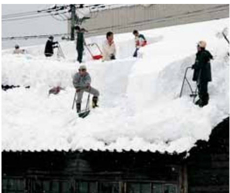
屋根雪下ろしは1人で行わないように
