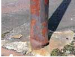
錆びついた支柱
