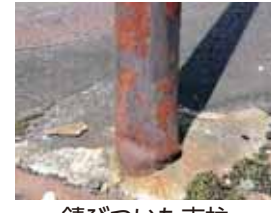
錆びついた支柱 台風時に歩道をふさいだ倒れた看板
