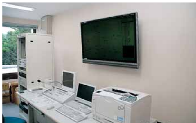
防災行政無線の整備に伴い設置される無線室
