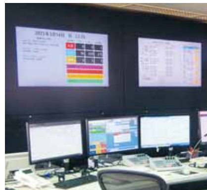
消防緊急通信指令システム
