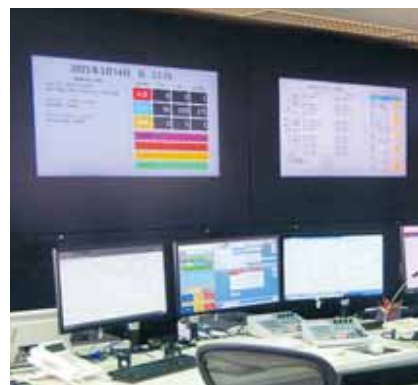
消防緊急通信指令システム
