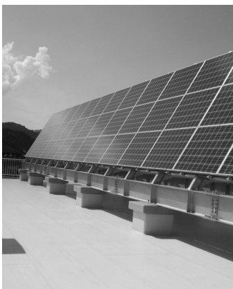
西小学校 太陽光発電施設
