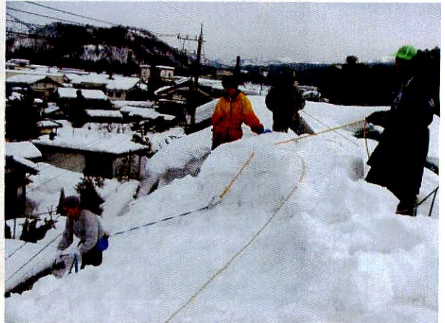
職員による危険家屋の雪下ろし（２） （ロープ、案全帯を用いた作業）
