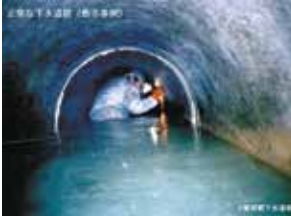
正常な下水道管（他市事例）
