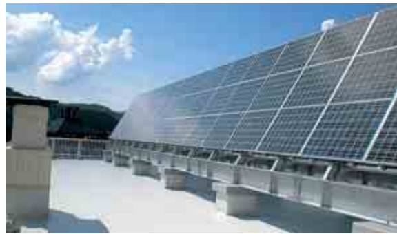
成器西小学校屋上の太陽光発電設備
