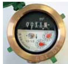
水道メーター
