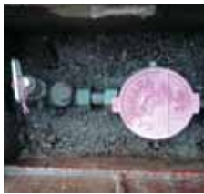
水道メーターと止水栓
