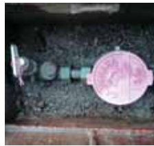
水道メーターと止水栓
