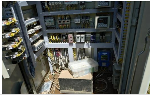
野向町薬師神谷（無停電電源装置故障）
