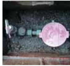
水道メーターと止水栓
