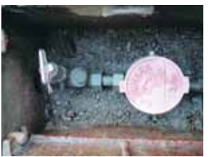
水道メーターと止水栓
