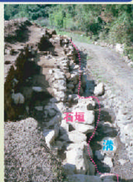
④水路改修予定地 掘り進めると石垣の裏から中世の石垣の跡が見つかりました。
