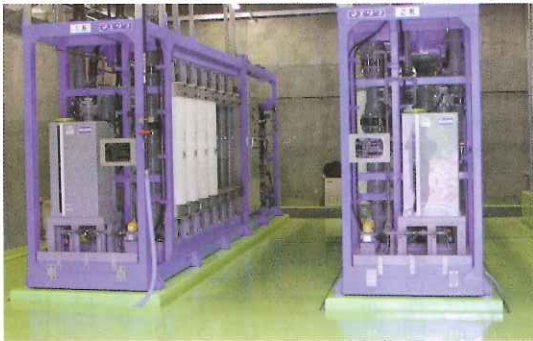
法恩寺浄水場膜ろ過施設
