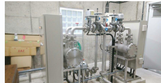
木根橋 紫外線処理装置
