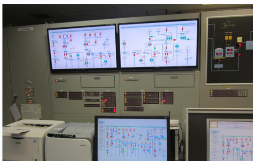
立川水源地遠方監視設備
