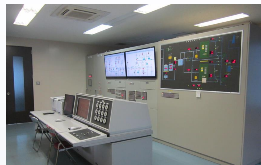
立川水源地遠方監視設備
